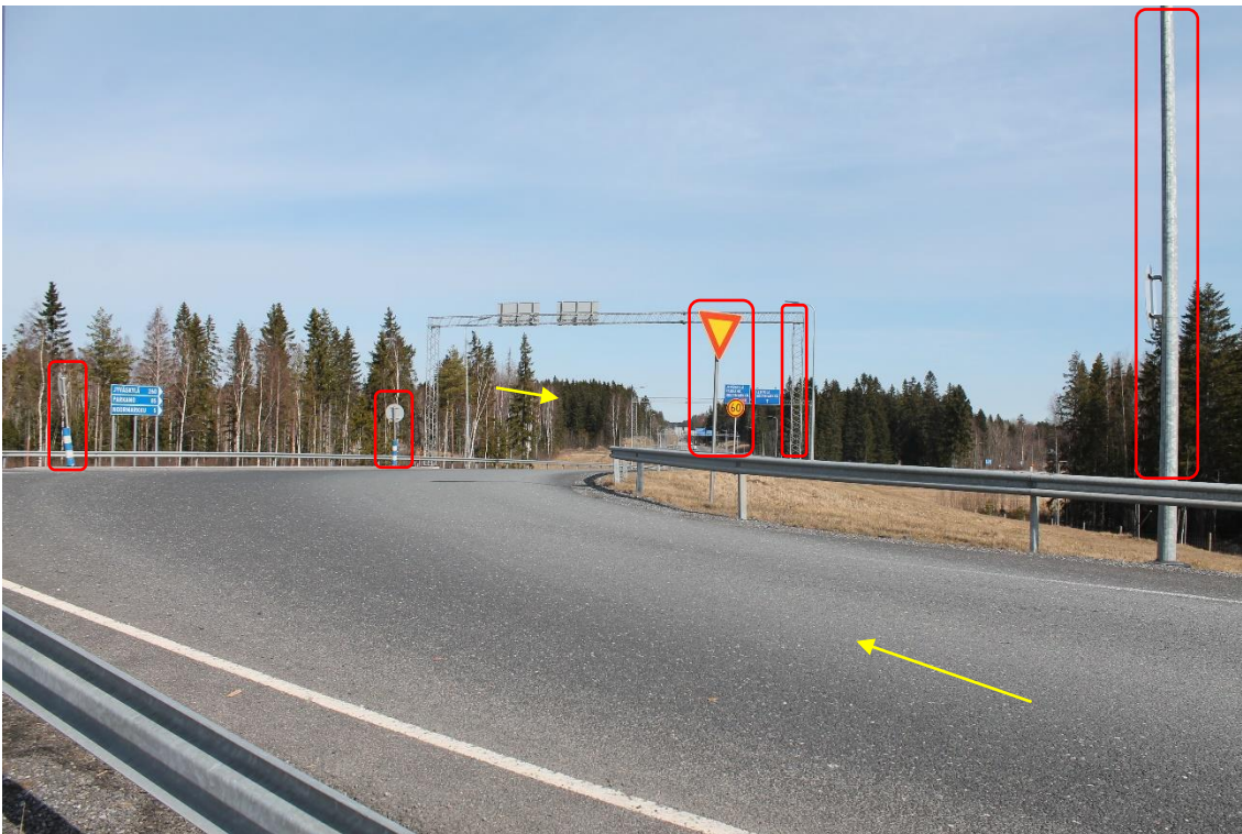
Pos 10 / Kuva 38. Kääntyminen tieltä 8 tielle 23. Merkitty valaisinpylväs, portaalirakenne ja kyltit on poistettava. Kaiteen korkeus 0,7 m.
