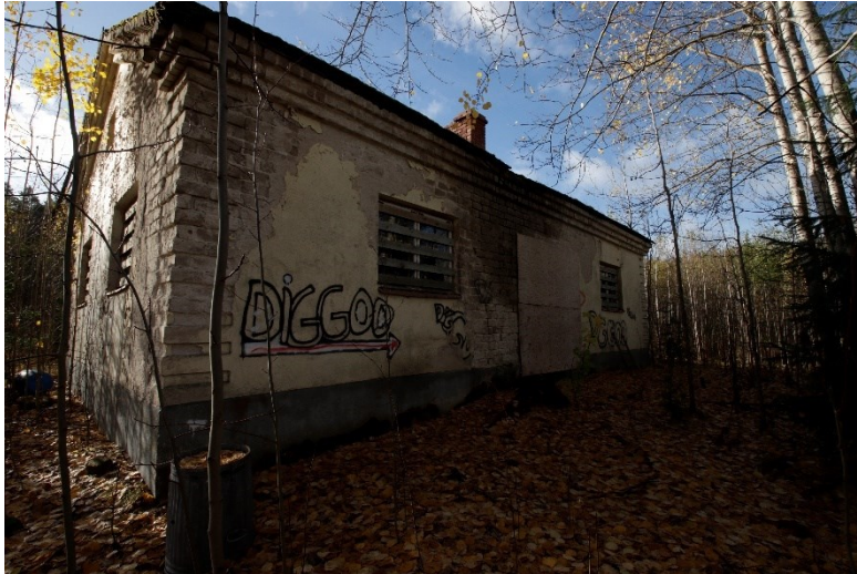
Kuva 25 Pesutuvan julkisivuun on lähivuosisikymmeninä kohdistunut ilkivaltaa.
