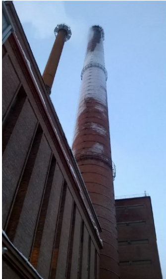
Kuva 18 Tehtaan vanha piippu jäässä uuden teräspiipun savukaasujen tiivistettyä piipun kylkeen (Sweco Rakennetekniikka Oy 2019)
