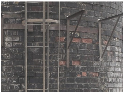
Kuva 19 Lohjonneita tiiliä ja halkeamia piipun kyljessä (Sweco Rakennetekniikka Oy, 2019)
