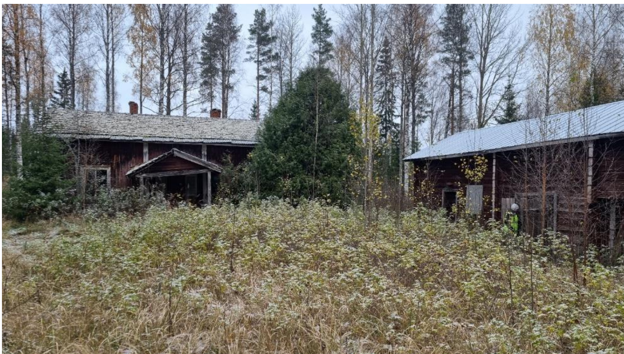
Kuva 19. Kaijanlammen pohjoispuolella sijaitsee huonokuntoinen autio talo ulkorakennuksineen. Pohjoiseen. SK.
