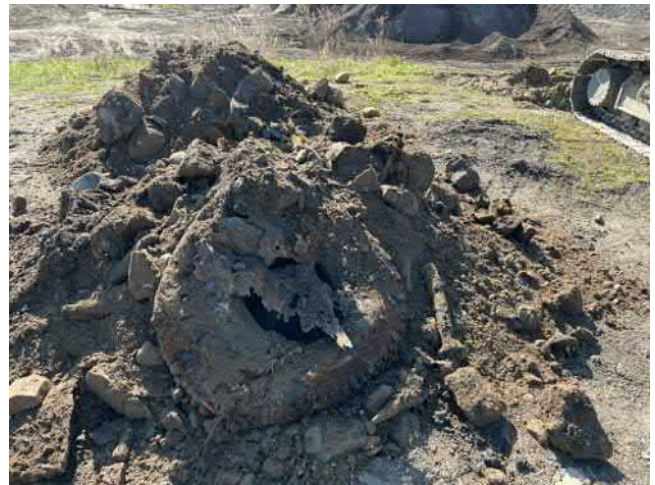
KK7 2-3m. Metalliputkea, rengas. Metallijätettä
