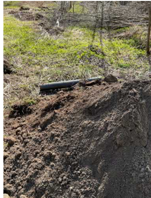
KK2 0-1 yksittäinen putken pala.
